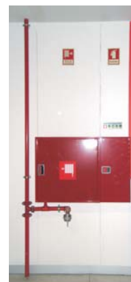
Figura 5 Exemplo de boca de incêndio armada do tipo carretel EN 671-1.
